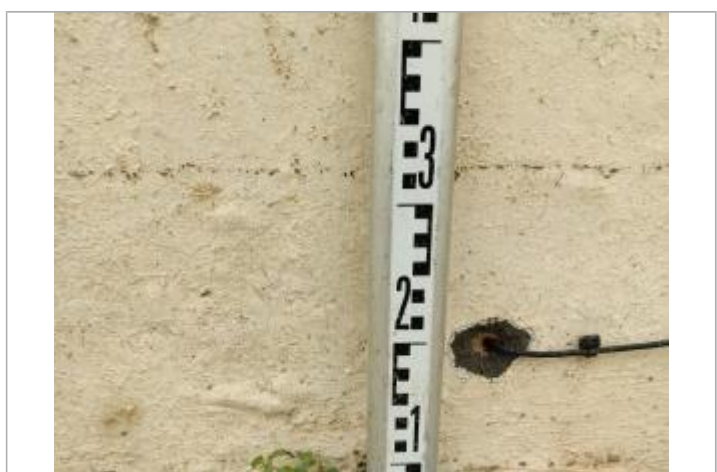
Trace sur le mur
