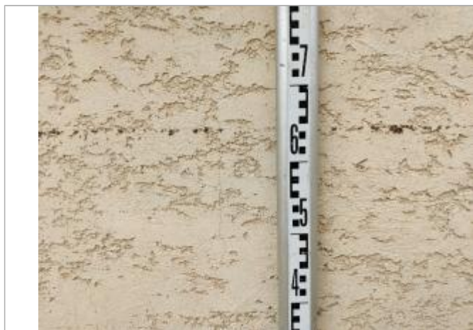
Trace sur le mur
