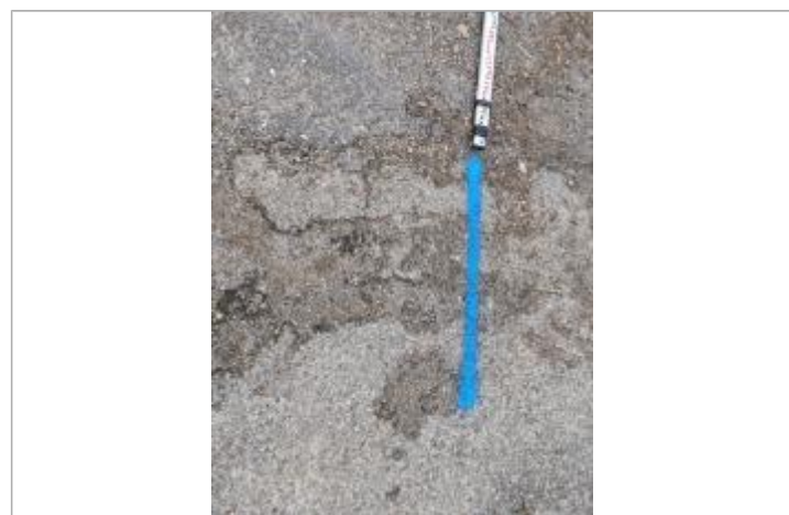
Dépôt au sol
