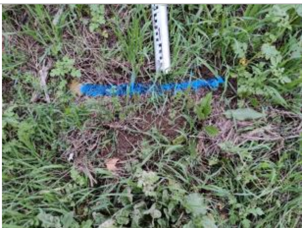
Dépôt contre la digue
