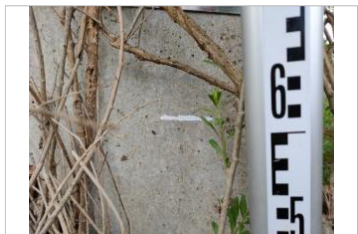
Trace sur le pylône
