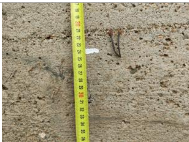
Trace sur la digue
