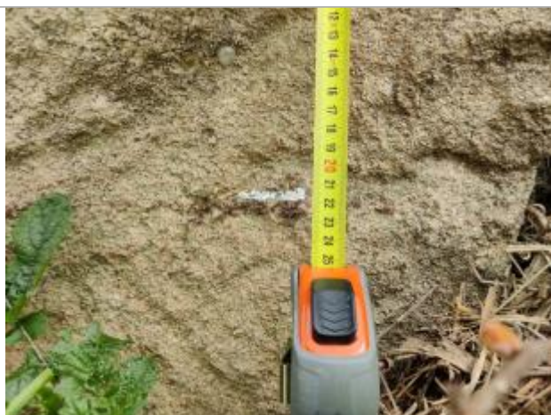
Trace sur une pierre de la digue
