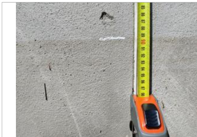
Trace sur le mur
