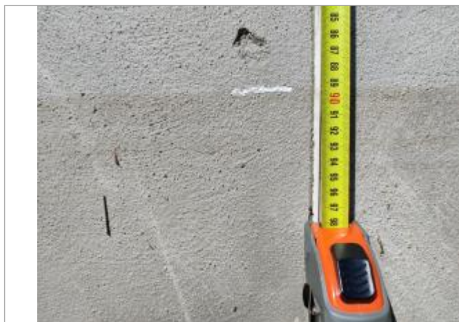
Trace sur le mur
