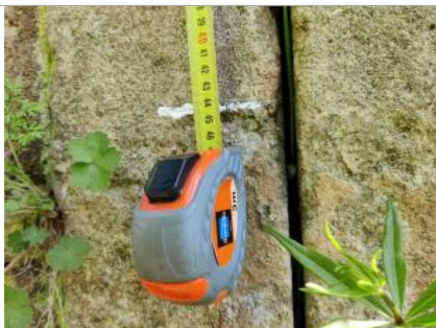
Trace sur la maçonnerie
