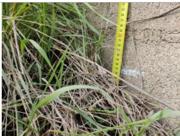
Trace sur la culée en parpaing
