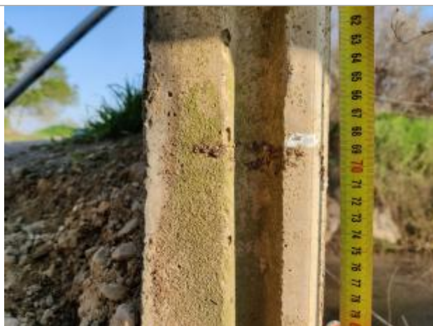
Trace sur le garde-corp
