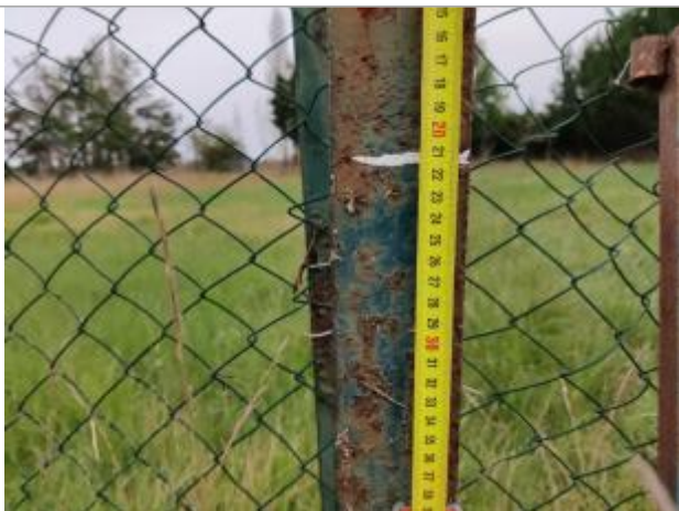
Trace sur le montant
