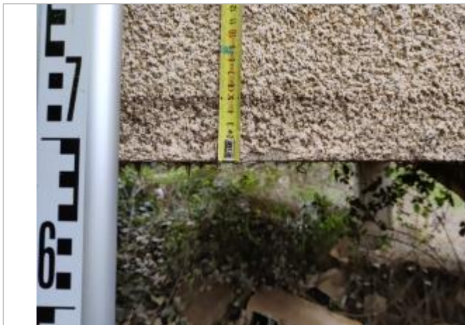
Trace sur le mur du transformateur
