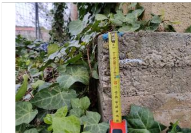
Trace sur les fondations du transformateur
