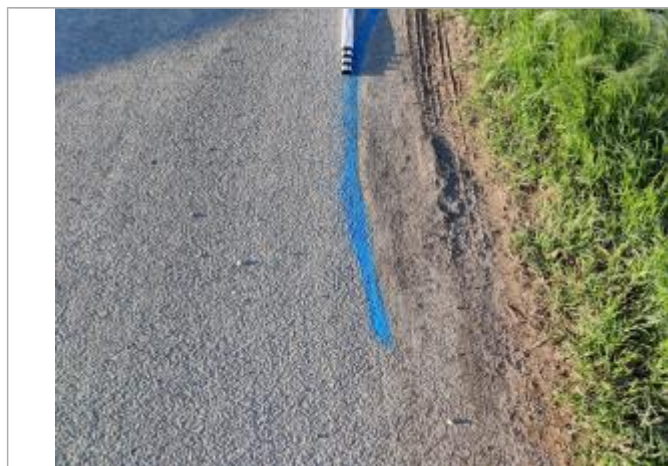
Dépôt sur la chaussée
