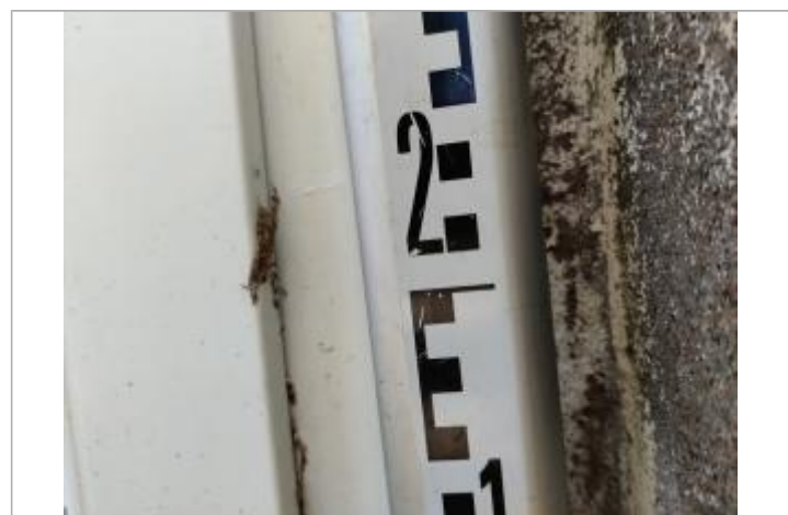
Trace sur le mur
