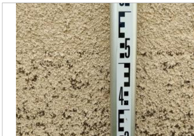
Trace sur le mur
