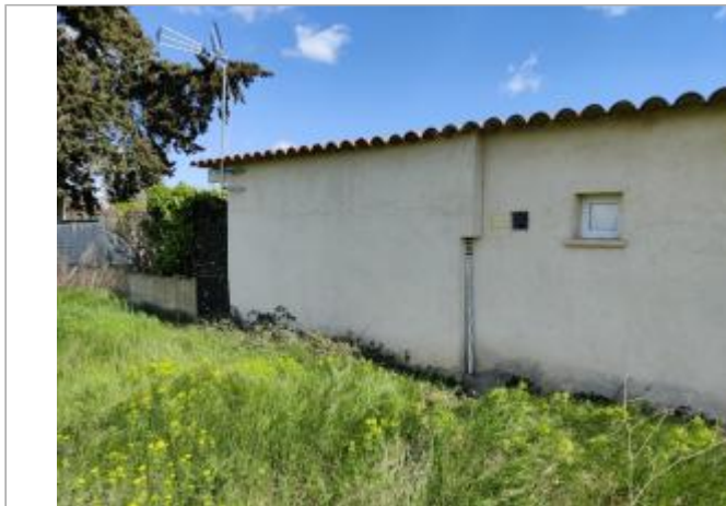
Mur de la maison
