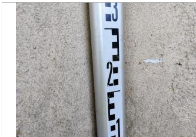
Trace sur le mur
