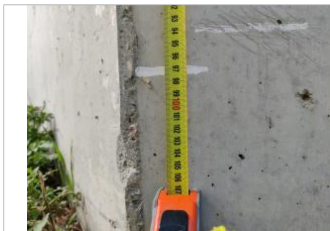
Trace sur la digue
