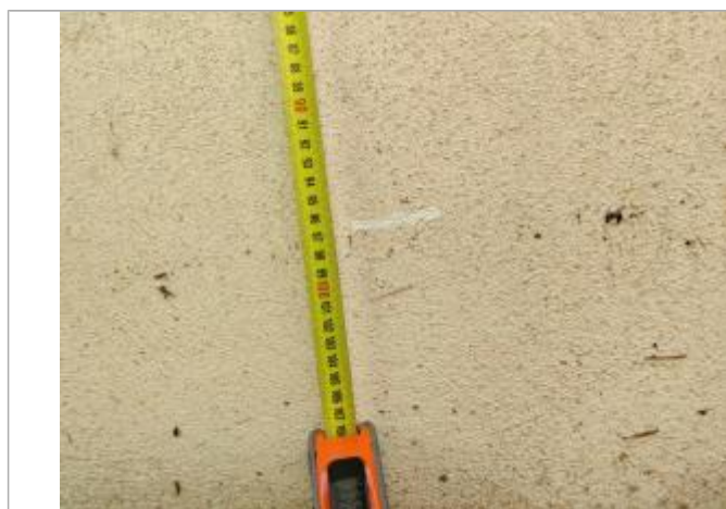
Trace sur le mur
