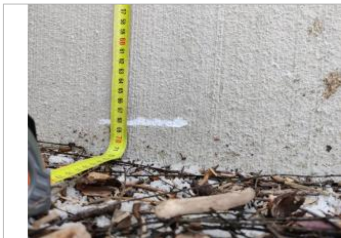
Trace sur le mur
