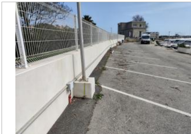
Massif béton de réverbère
