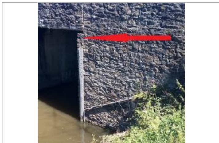
Echelle limnimétrique de la station Vigicrues de Cadoret-Pleugriffet
