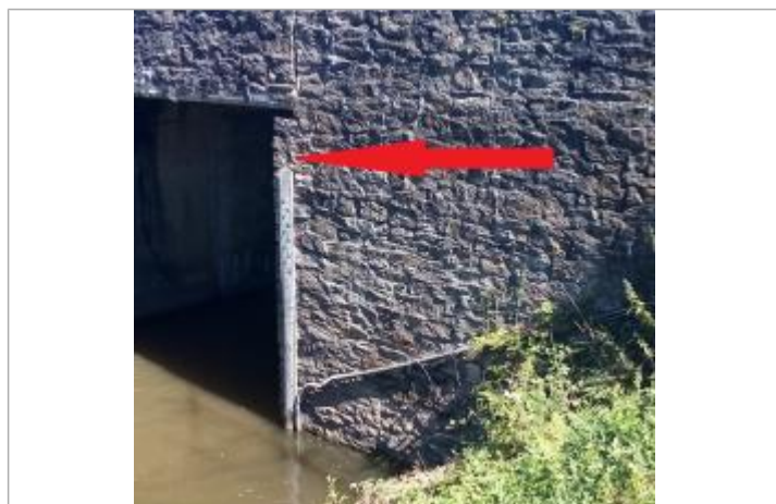
Niveau de la crue de novembre 1930 reporté sur l'échelle de la station Vigicrues
