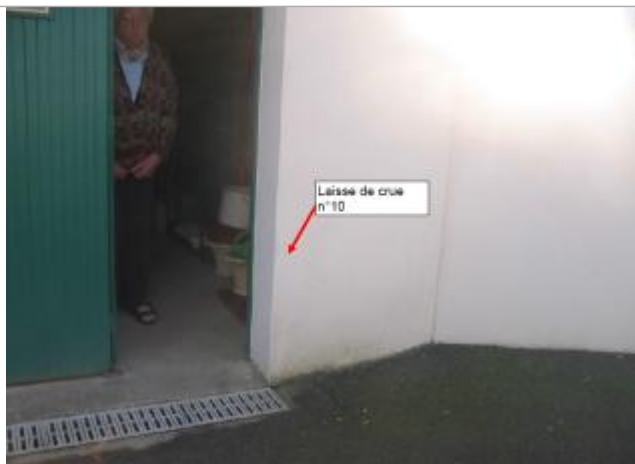
Garage lors du relevé des laisses de crues en 2003
