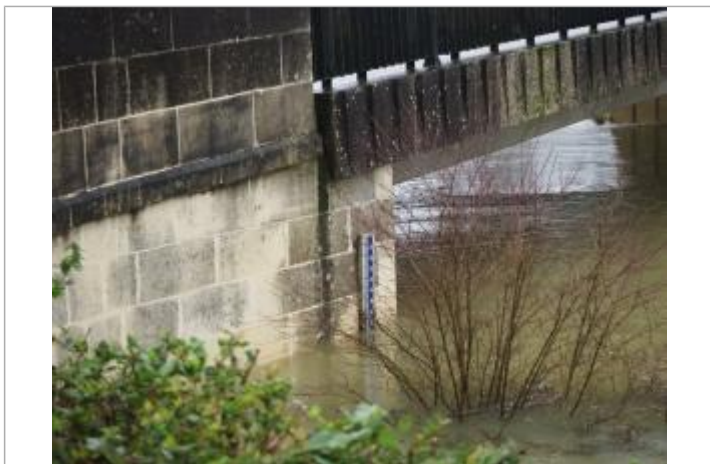
Niveau eau au pic
