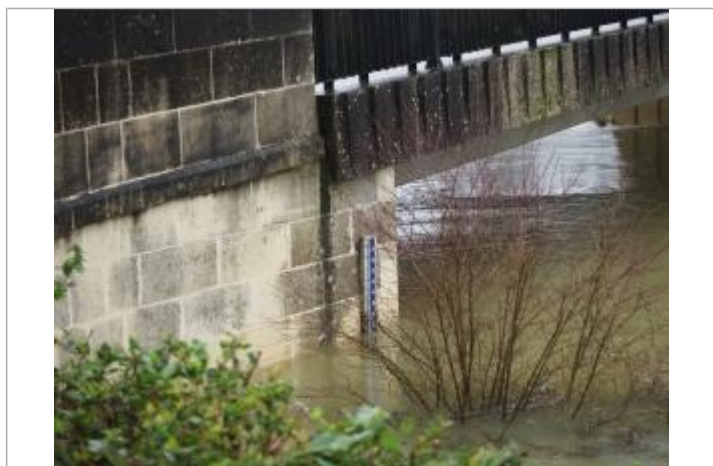
Niveau eau au pic
