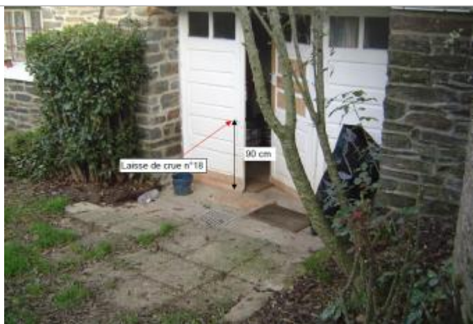
Porte d'entrée lors du relevé de laisses
