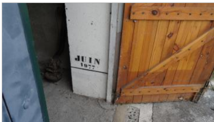
Trait de peinture indiquant la hauteur d'eau atteinte par la crue du 19 mai 1977 (mention "juin" erronée)
