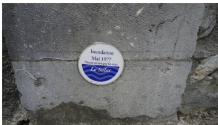
Macaron en tôle émaillée reportant le niveau de la crue du 19 mai 1977.
