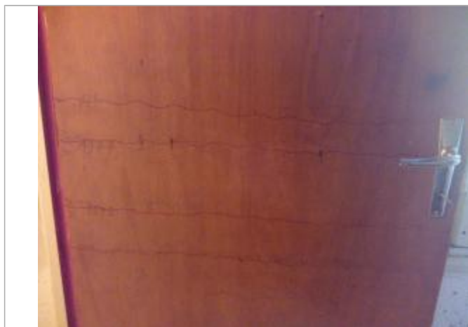
Trait au crayon marquant la PHE de la crue du 03/12/1995
