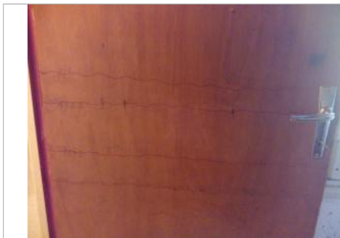
Trait au crayon marquant la PHE de la crue du 05/10/1992.
