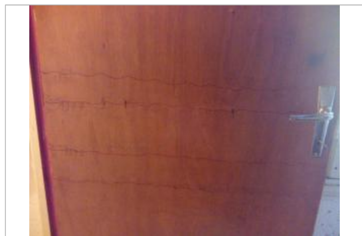
Trait au crayon marquant la PHE de la crue du 19/05/1977
