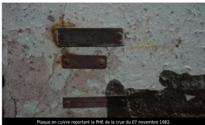
Plaque en cuivre reportant la PHE de la crue du 07 novembre 1982.
