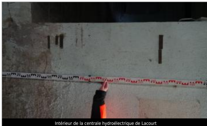
Intérieur de la centrale hydroélectrique de Lacourt
