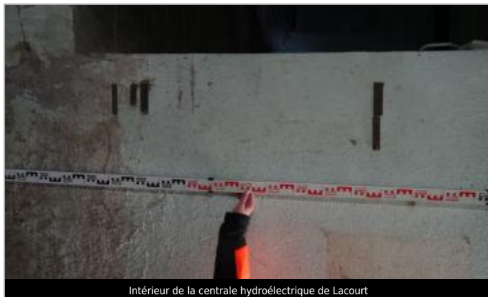
Intérieur de la centrale hydroélectrique de Lacourt
