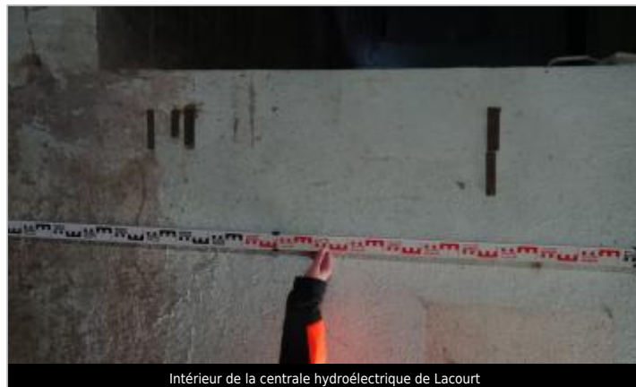
Intérieur de la centrale hydroélectrique de Lacourt
