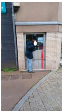
Laisse de crue à 1.20 m/sol
