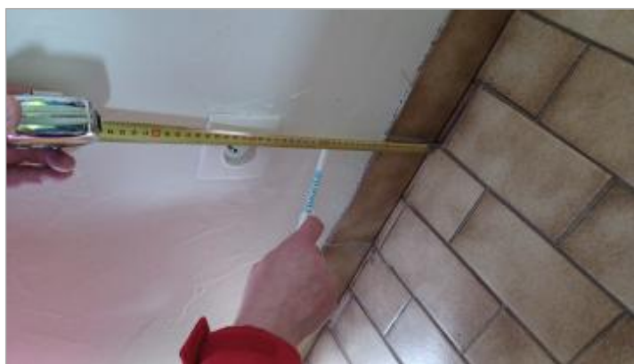
Laisse de crue à 20 cm/sol.
