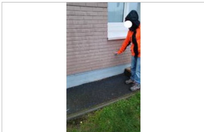
Laisse de crue à 67 cm/sol.
