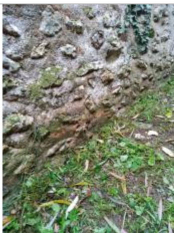
Laisse de crue au sol
