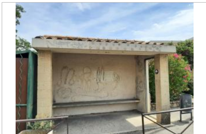
crue du Rhône
