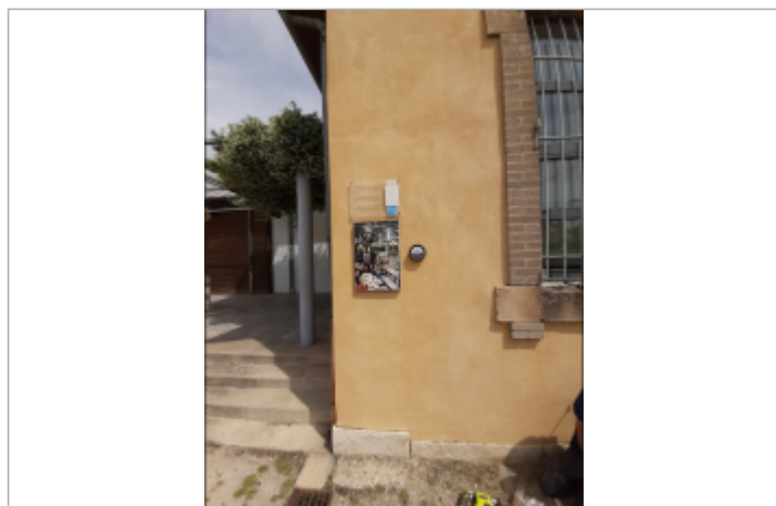
crue du Rhône
