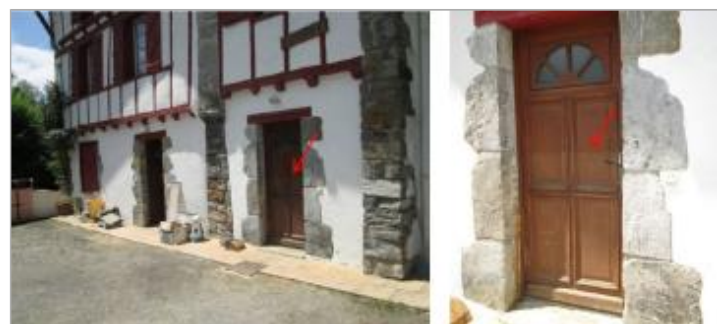
Vue de la laisse - auteur : HYDRATEC
