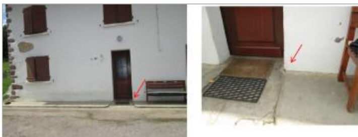
Vue de la laisse - auteur : HYDRATEC
