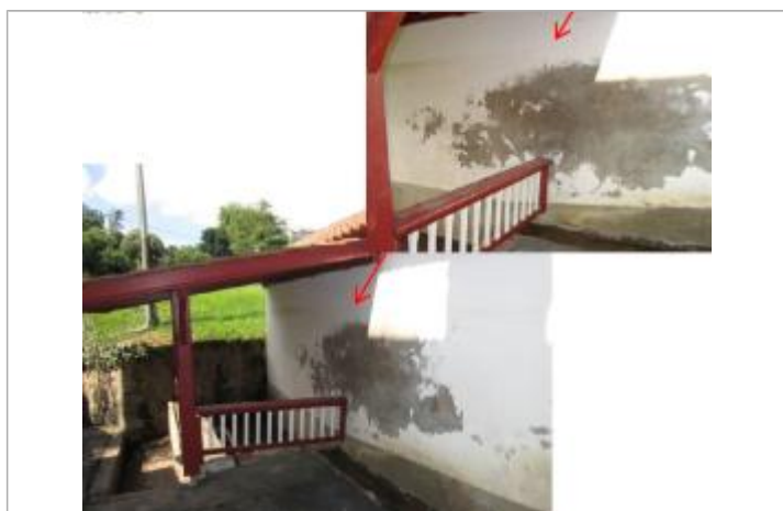
Vue de la laisse - auteur : HYDRATEC
