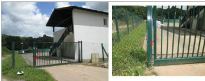
Vue de la laisse - auteur : HYDRATEC
