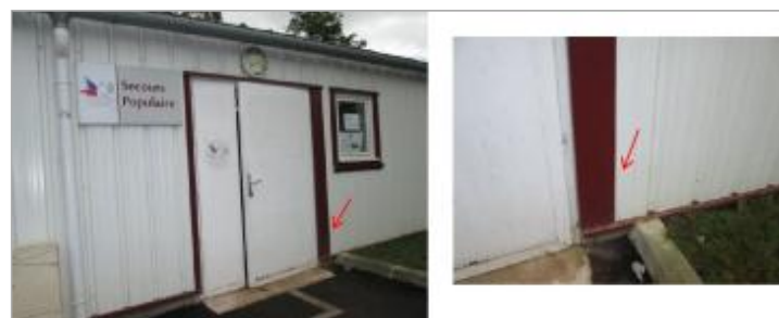
Vue de la laisse - auteur : HYDRATEC
