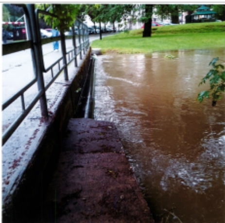
pont entre la rue du Moulin et la rue de la corderie, eau jusqu'au pont
