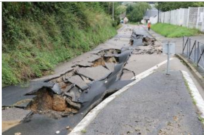
Affaissement de la rue suite aux événements orageux
