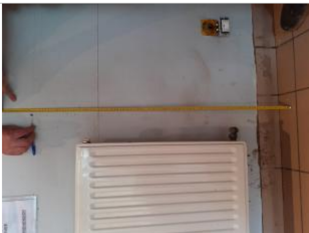
Hauteur d'eau à 99 cm à partir du sol dans le hall d'entrée du cabinet médical
