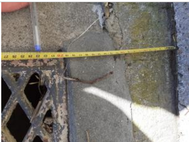
Trace de végétation dans la grille d'aération à 23 cm du sol
