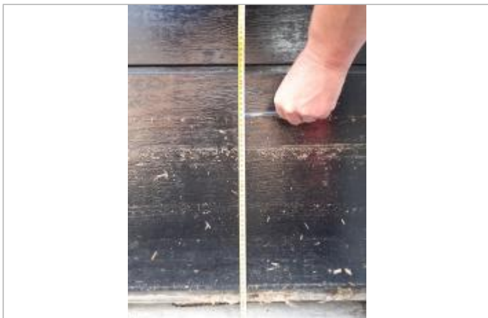
Trace d'eau boueuse sur porte garage à environ 38 cm du sol
